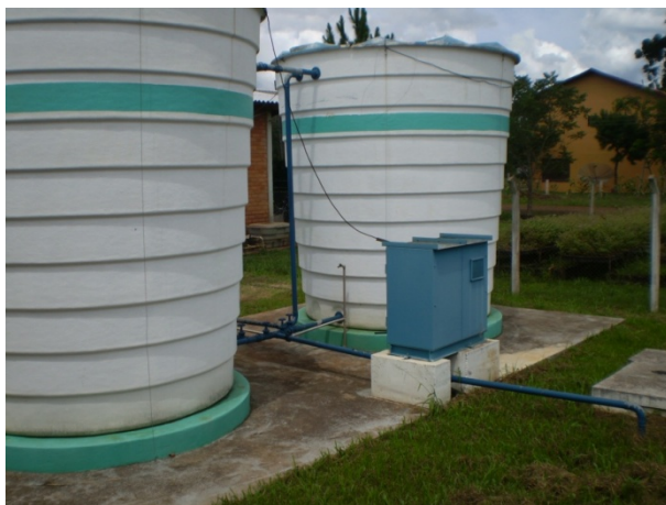
Figura 8.6 - Reservatórios capacidade 40m 3
