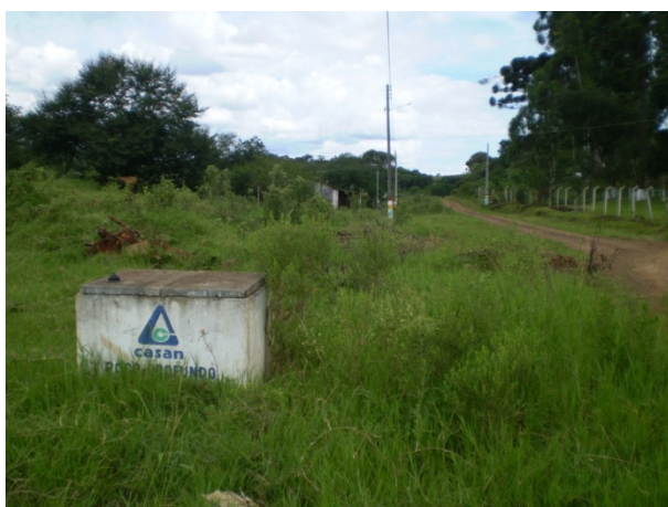
Figura 8.2 Poço Profundo - Captação água subterrânea.
