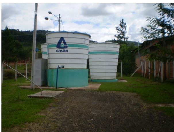
Figura 8.5 - Estação de Tratamento de Água- Cloração e fluoretação. Fonte: Consórcio MPB/ESSE/Sanetal
