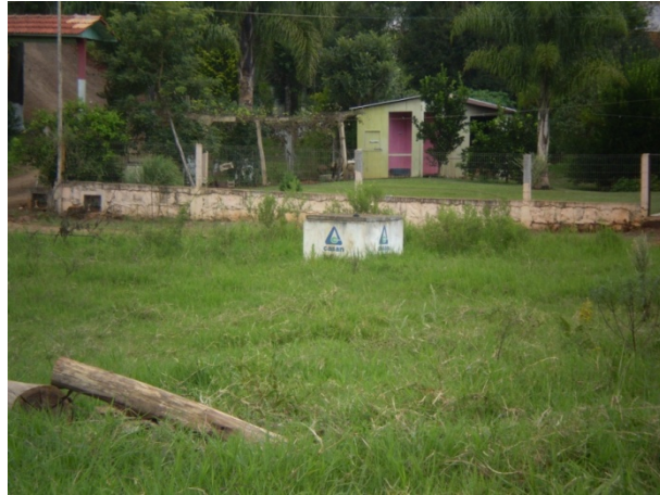
Figura 8.3 - Poço Profundo - Captação água subterrânea. Fonte: Consórcio MPB/ESSE/Sanetal
