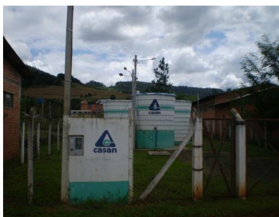
Figura 8.4 Estação de Tratamento de água- Cloração e fluoretação. Fonte: Consórcio MPB/ESSE/Sanetal
