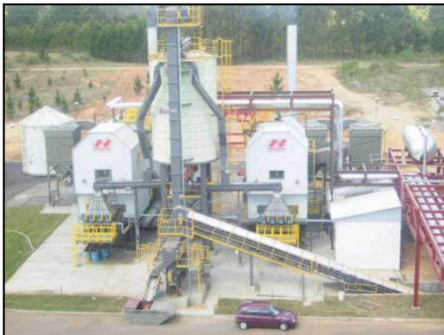
Figura 10: Modulo Gerador de Energia Eletrica
