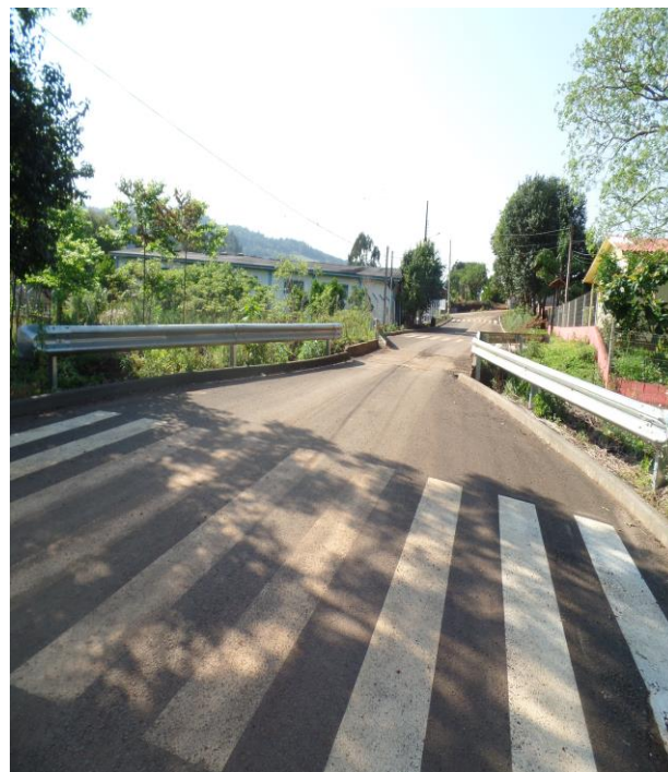
Figura 21. Proteção instalada ponte estreita na Rua Santa Clotilde
