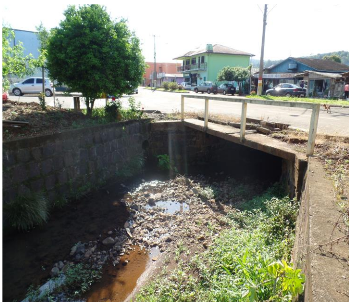
Figura 14. Ponto de canalização da Sanga São Pedro (próximo a Rua Santa Clotilde)
