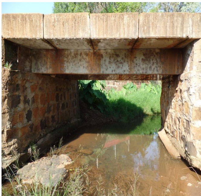
Figura 12. Ponte Rua Santa Clotilde.
