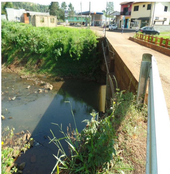
Figura 20. Canal sem a previsão correta das calçadas públicas, proporcionando risco à população.
